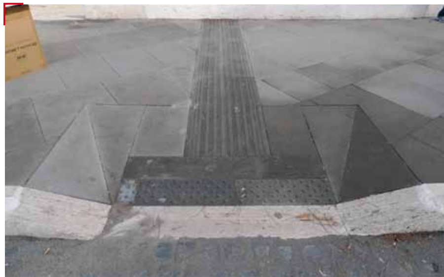
Fig.7: Investigaciones recientes señalan la importancia de separar la señalización de guía y la de advertencia para facilitar la detección de ésta última, como en este vado en Roma.
